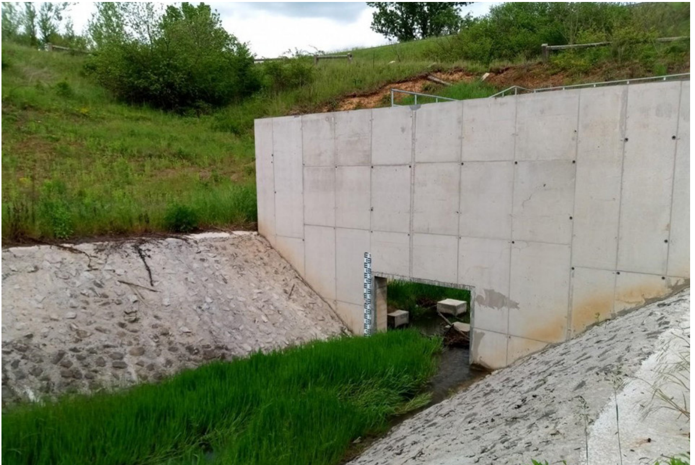
28. ábra: A Hévíz-patakot keresztező 2. sz. főút egy nem megfelelően méretezett átvezetőcsatornával
