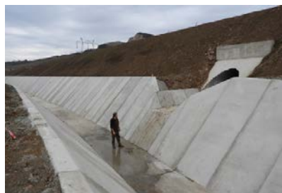
Fig. 66. Construcțiile masive de beton destinate drenajului apelor pluviale ce provin de pe autostradă, afectează în mod neplăcut peisajul și nu permit utilizarea canalelor ca pasaje pentru faună. O astfel de soluție reprezintă, de asemenea, o capcană pentru animalele mai mici care vor avea dificultăți în a părăsi canalul. (Foto: Ivo Dostál)
