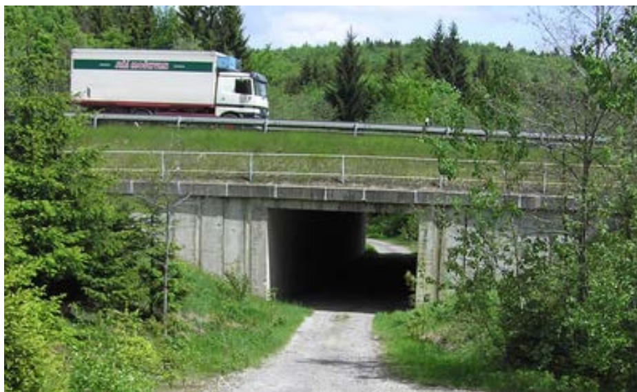
Fig. 103. Acest tip de subtraversare pentru un drum forestier nu reprezintă un pasaj potrivit pentru faună. Dimensiunile: lățime = 6 m, înălțime = 5 m, lungime = 33 m ( OI = 0,9 ) sunt insuficiente pentru mamiferele mari, iar mamiferele mijlocii cum ar fi căpriorul sau mistrețul vor folosi acest tip de trecere numai atunci când perturbările sunt complet eliminate (pereți de protecție de-a lungul autostrăzii, activități umane limitate). Republica Cehă, autostradă D1. (Foto: Václav Hlaváč)
