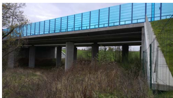
Fig. 101. Suprafața naturală îmbunătățește semnificativ funcționalitatea unui pasaj pentru faună sălbatică. Un perete de protecție contribuie la o mai bună utilizare a pasajului de către faună, datorită eliminării perturbărilor. Republica Cehă. (Foto: Agenția pentru Conservarea Naturii din Republica Cehă)
