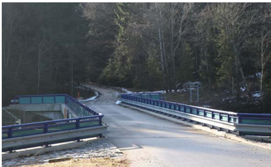
Fig. 94. La acest pod a fost instalată o balustradă care nu este transparentă. Cu toate acestea, suprafața de asfalt este complet inadecvată pentru deplasarea animalelor, prin urmare această soluție este, în general, nepotrivită. Republica Cehă, D1 lângă Jihlava. (Foto: Václav Hlaváč)
