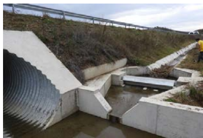
Fig. 65. Canalele cu diametru mai mare ar trebui să fie întotdeauna adaptate pentru a permite deplasarea speciilor pe sub autostradă. Ieșirea este, în acest caz, amenajată tehnic într-un mod care nu oferă nicio posibilitate pentru anumite specii să folosească acest canal pentru a traversa autostrada. În plus, poate deveni o capcană periculoasă pentru animale mici (precum amfibieni, mamifere). (Foto: Václav Hlaváč)
