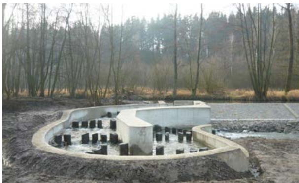
Fig.112. Pasaje pentru pești sub formă unui canal de deviație: pentru a depăși un obstacol de 1,3 m înălțime, a fost necesar să se creeze un pasaj pentru pești cu o lungime totală de 40 m. Republica Cehă. (Foto: Václav Hlaváč)
