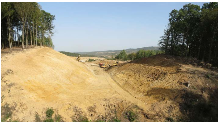
Fig. 45. Construcția de drumuri în mediul montan duce deseori la distrugerea habitatelor valoroase. Autostrada Lugoj-Deva. (Foto: Radu Moț)
