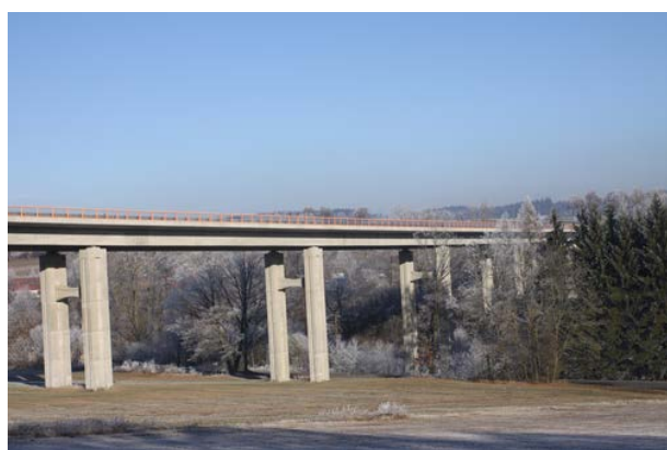
Fig. 97. Suprafețele de sub viaductele care trec peste văi servesc ca pasaje de faună pentru cele mai multe specii, inclusiv mamifere mari. Ele pot, în condiții bune, să permită conectarea unor ecosisteme. Republica Cehă. (Foto: Václav Hlaváč)
