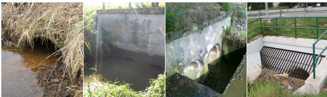
Fig.109. Exemple de soluții necorespunzătoare. Canale care nu permit pătrunderea animalelor (Foto: Lukáš Poledník - a) și d), Václav Hlaváč - b), Jitka Větrovcová - c))
