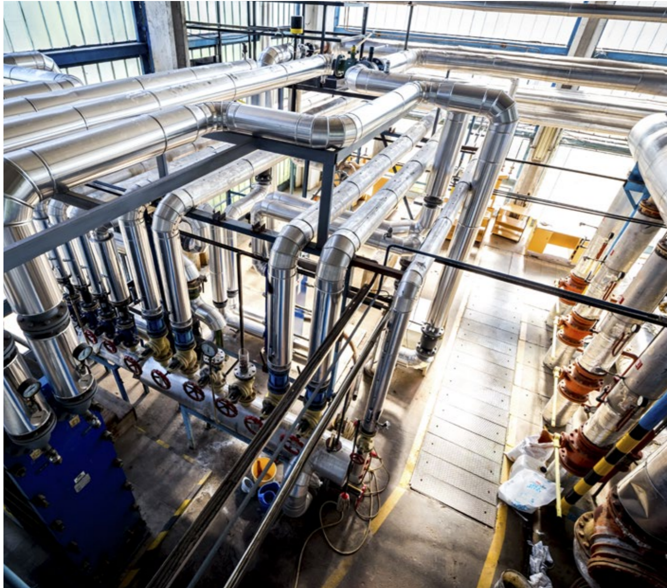
SZETÁV North 1A Boiler room
