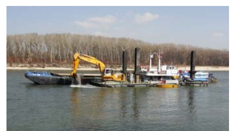
Stabilisation critical scours
