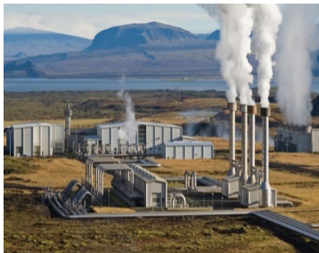
Geothermal power plant Geotermikus erőmű
