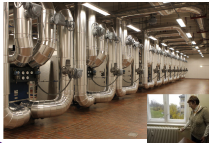
District heating Távfűtés
